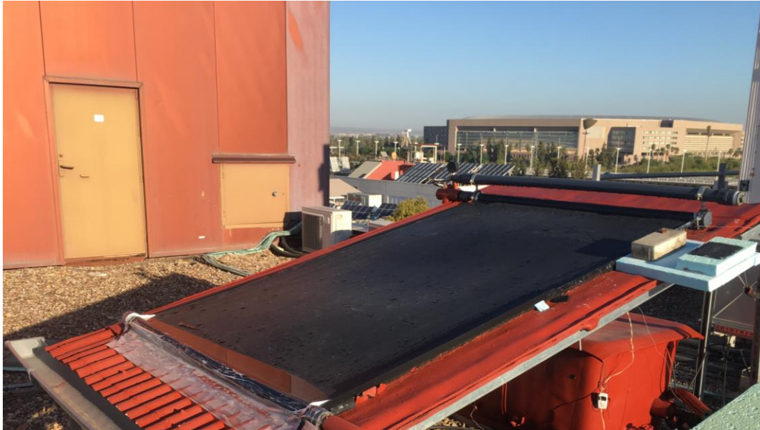
Ilustración 49. Disipador tras pruebas en modo agua fuera
