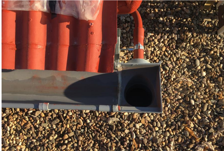
Ilustración 53. Canalón de recogida
